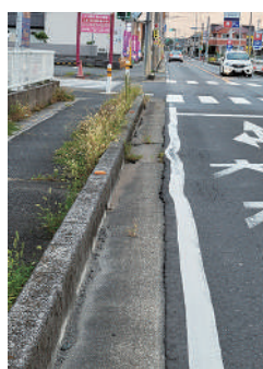
凸凹となっている路肩の補修を
